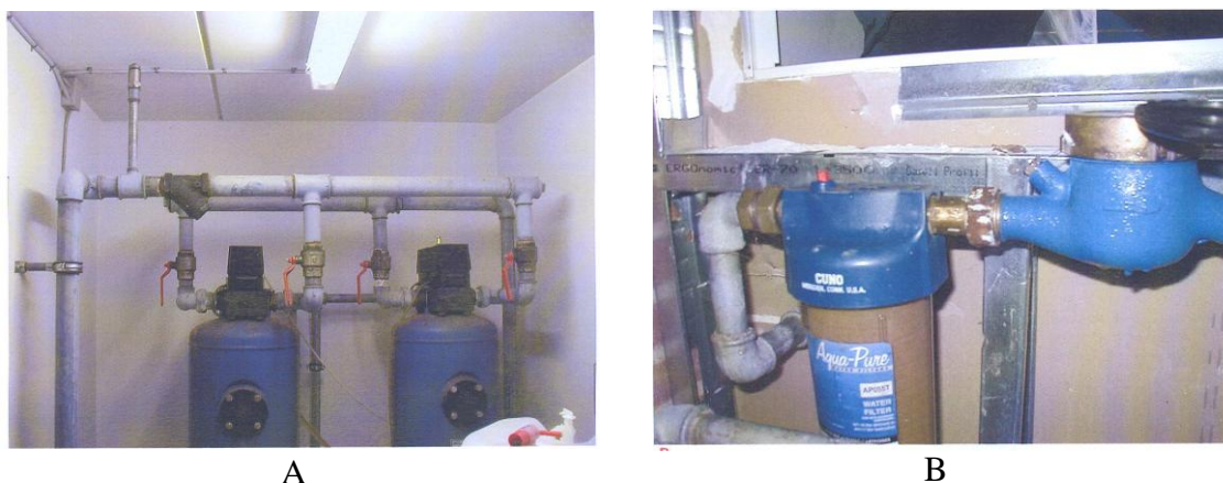
Figur 2.1 A. Forkert/ulovlig installation af blødgøringsanlæg i forbindelse med fællesvaskeri. Der er bl.a. fejl i forbindelse med monteringen af vakuumventilen B. Ulovligt filter anbragt uden sikringer før vandmåler i installation i børneinstitution
